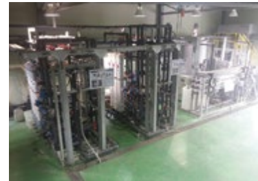
대구 지능형 막여과 고도정수처리 Pilot Plant
