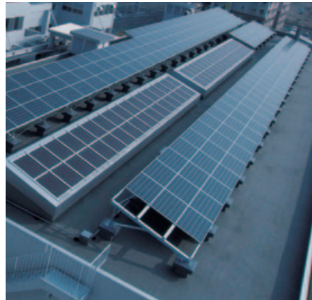
太陽光発電システム
