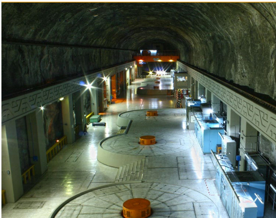
▼ Casa de máquinas. Central Hidroeléctrica San Carlos.
