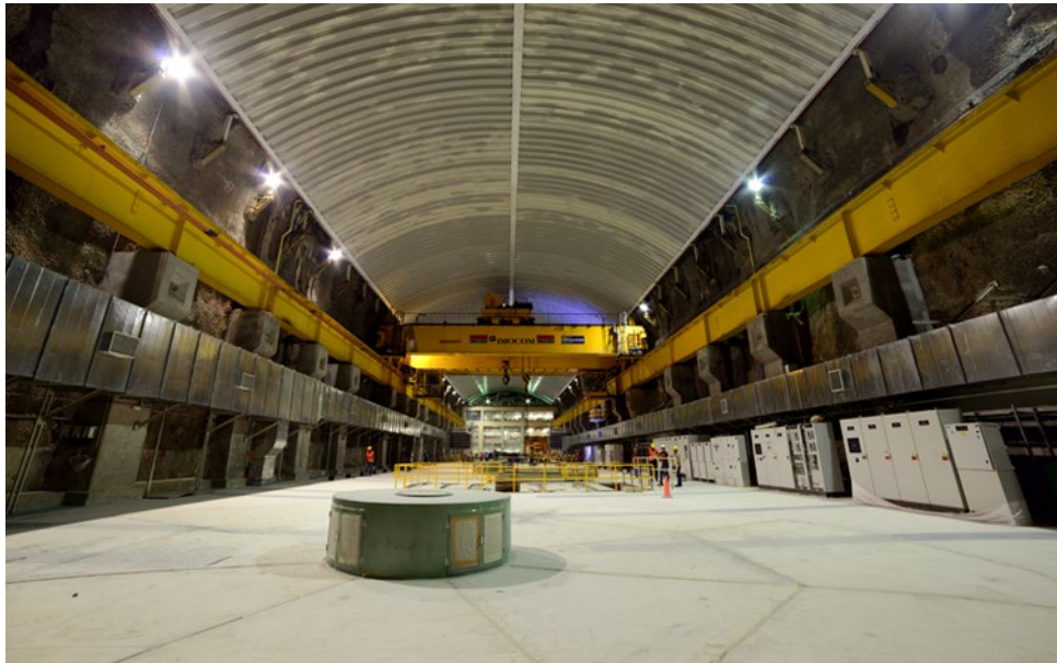
▼ Casa de máquinas. Central Hidroeléctrica Sogamoso.
