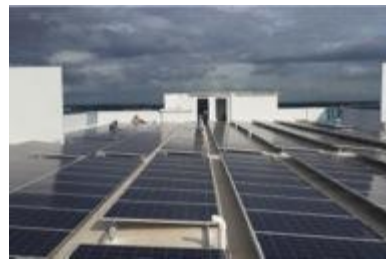
Paneles solares – Hotel Crowne Plaza Aeropuerto
