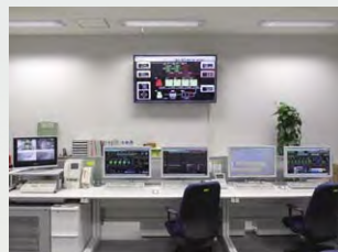
錦糸町熱供給・中央監視システム (東京都墨田区)
