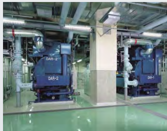
西新宿六丁目地区地域冷暖房施設 第3プラント・地域冷暖房(東京都新宿区)
