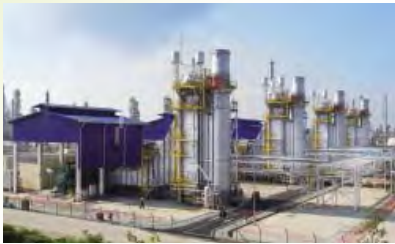
ペトロナス ペナピサン(マラッカ) コージェネレーションプラント(マレーシア)
