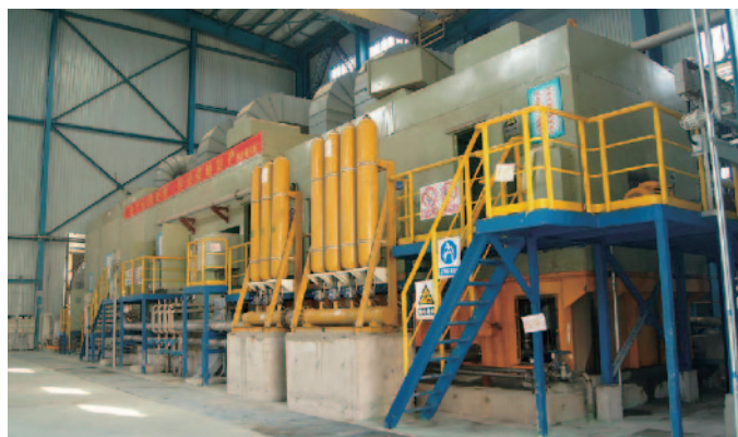
迁钢公司2号50MWCCPP发电机组
