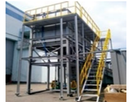
고효율 응집침전 Pilot Plant
