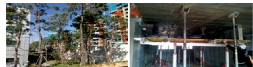
· 동탄센트럴하이 현장 : 소음피해 예상지역의 소음저감을 위해 수목 이식 및 흡음형 방음벽 설치로 민원예방 · 가재울4구역 주택재개발 현장 : 거푸집 해체시, Drop-head 시스템을 도입해 낙하충격을 최소화하여 소음저감
