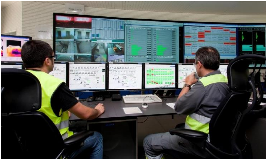
Personal sala de control planta de Valorización Energética.
