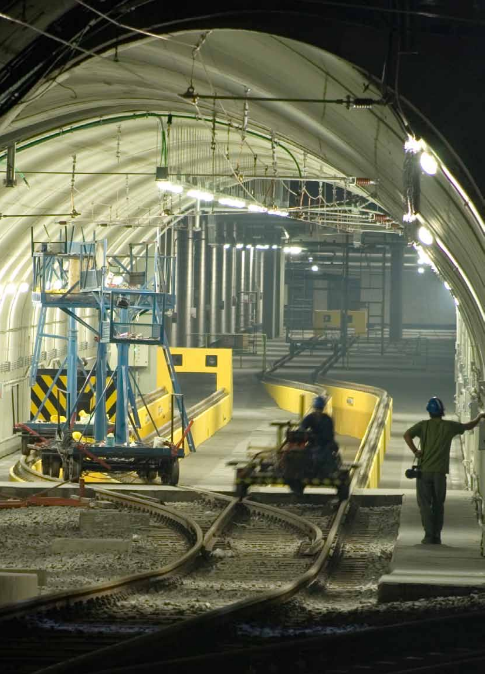
Señalización y energización de la línea H de subterráneo, Ciudad Autónoma de Buenos Aires.
