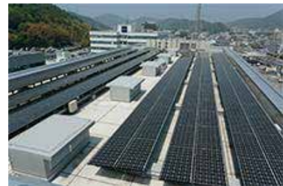
本社内屋の屋上に太陽光発電パネルを設置
