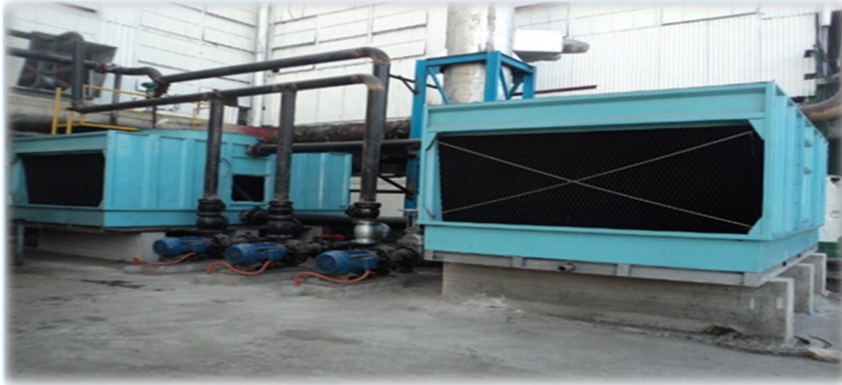
Torre de Enfriamiento N°2
