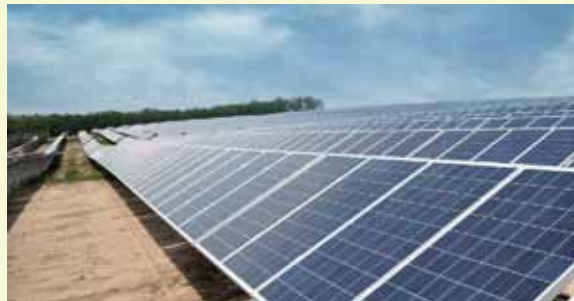
불가리아 체르베니아코보 (Chervenikovo) 태양광 발전소
