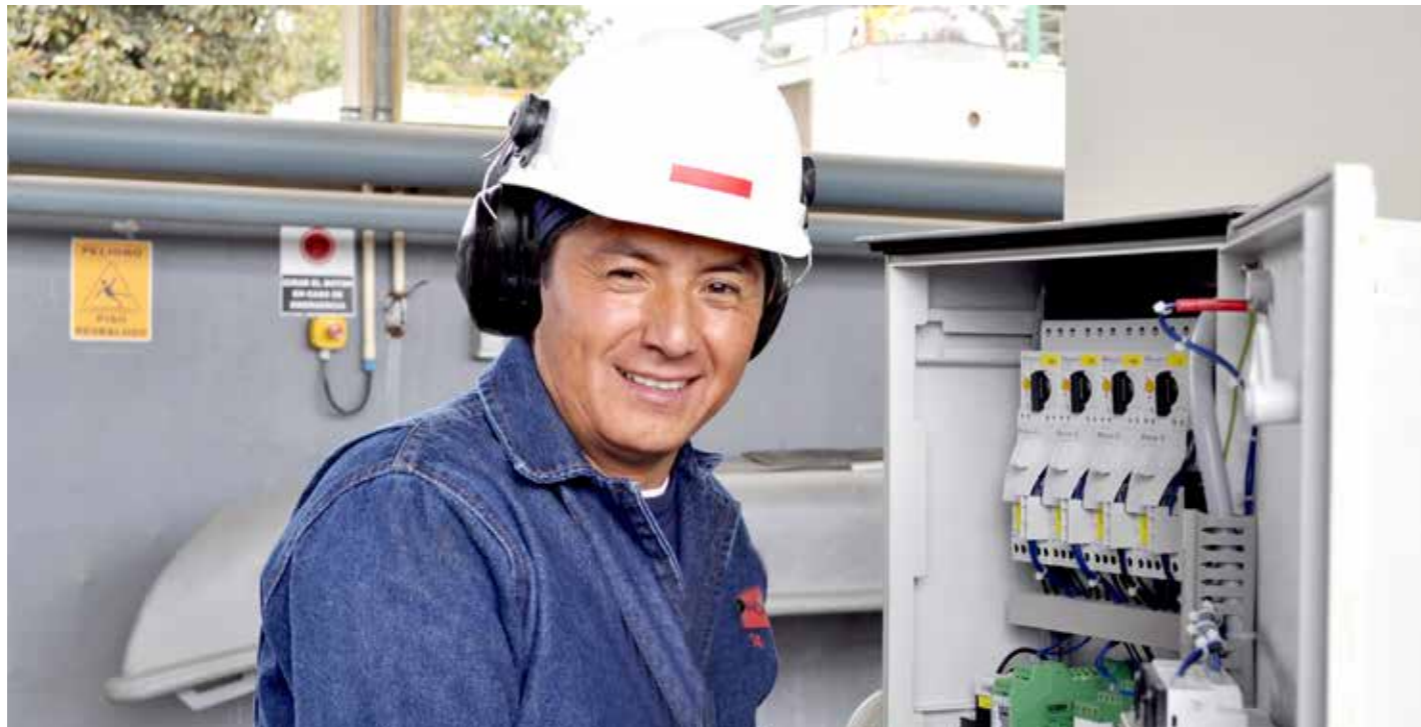
Control de equipos eléctricos. Planta de Aves Yaruquí.
