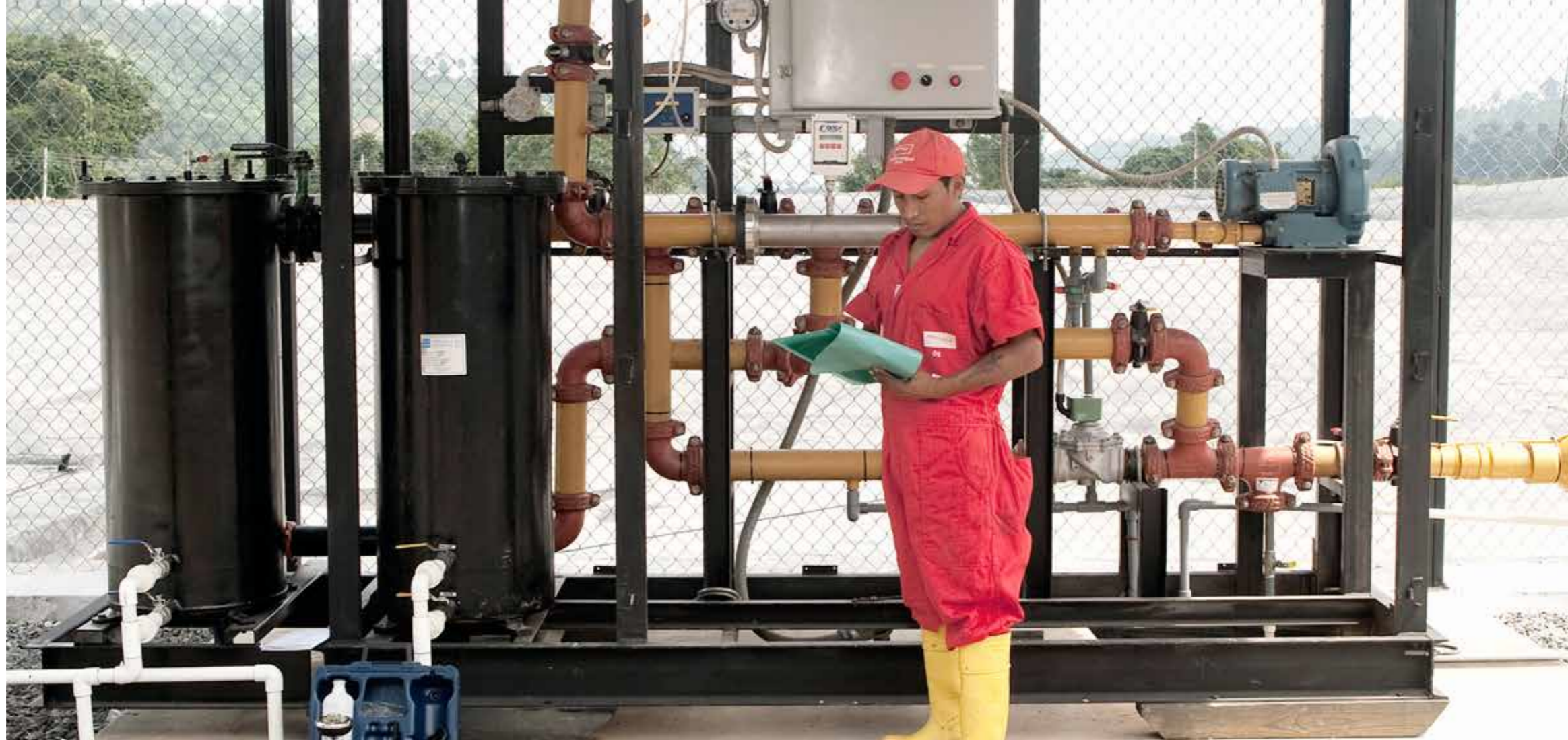
Control en Biodigestor. Granjas Toachi.
