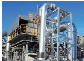
千葉工場に設置した排熱ボイラー
