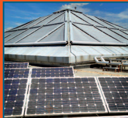
Placas solares en la cubierta del edificio de Madrid
