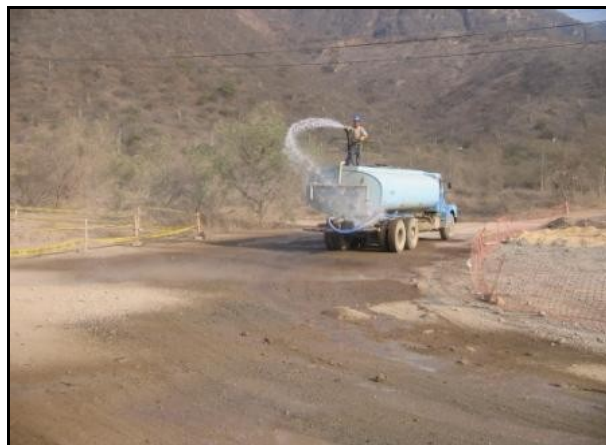
Control para evitar la generación de polvo
