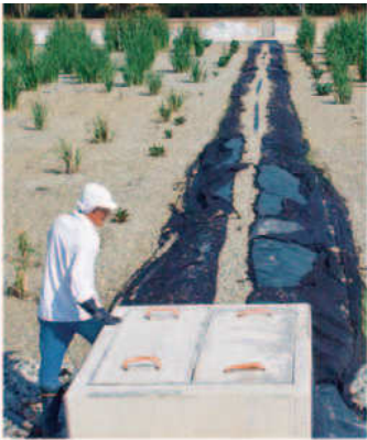
Humedales para el tratamiento de las aguas residuales. Compañía Nacional de Chocolates, Fábrica Rionegro, Antioquia - Colombia.
