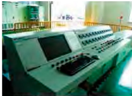
AC变流器试验系统
