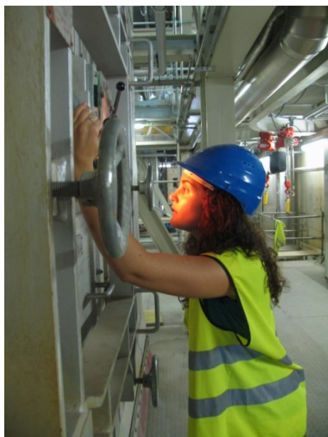
Personal planta de incineración de valorización energética.
