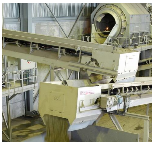
Planta de escorias.
