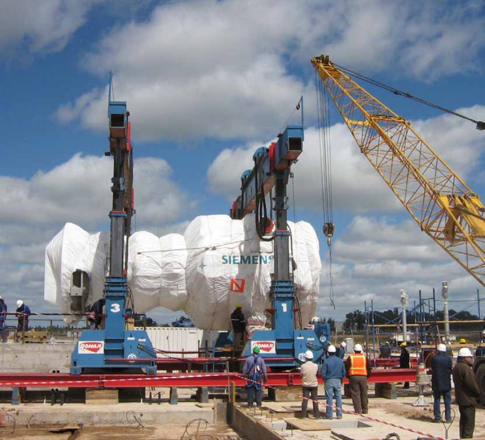
Central Termoelectrica Manuel Belgrano, Campana, Provincia de Buenos Aires.
