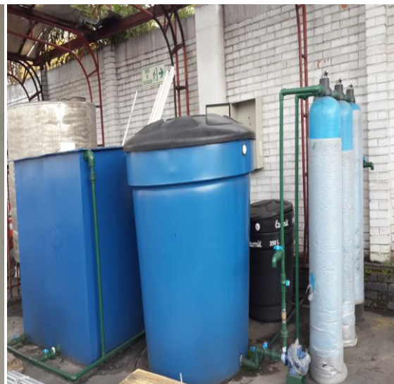
Foto: Planta de tratamiento de agua residual industrial.
