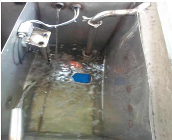
Foto: Tanque subterráneo de almacenamiento de agua.
