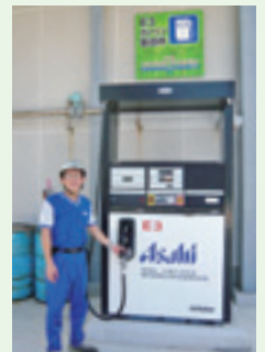
バイオエタノールを3%混合したE3ガソリンの製造装置
