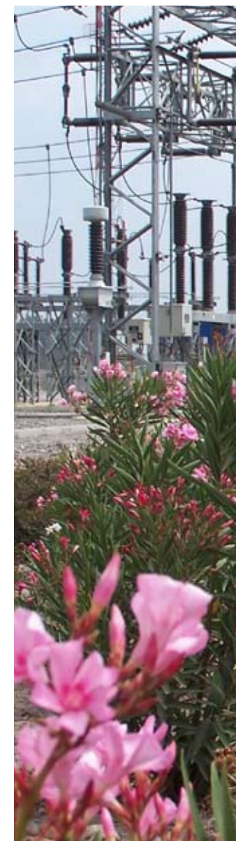
Arborización en subestación de poder.
