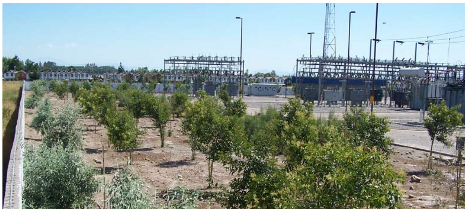
Arborización en subestación Chena.
