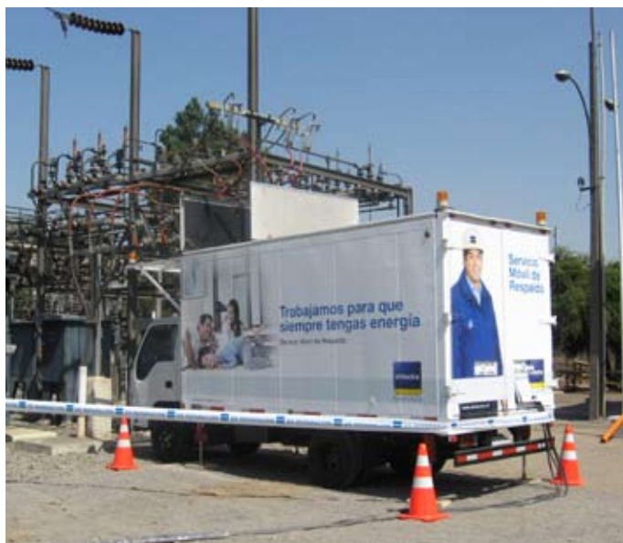
Subestación eléctrica móvil.
