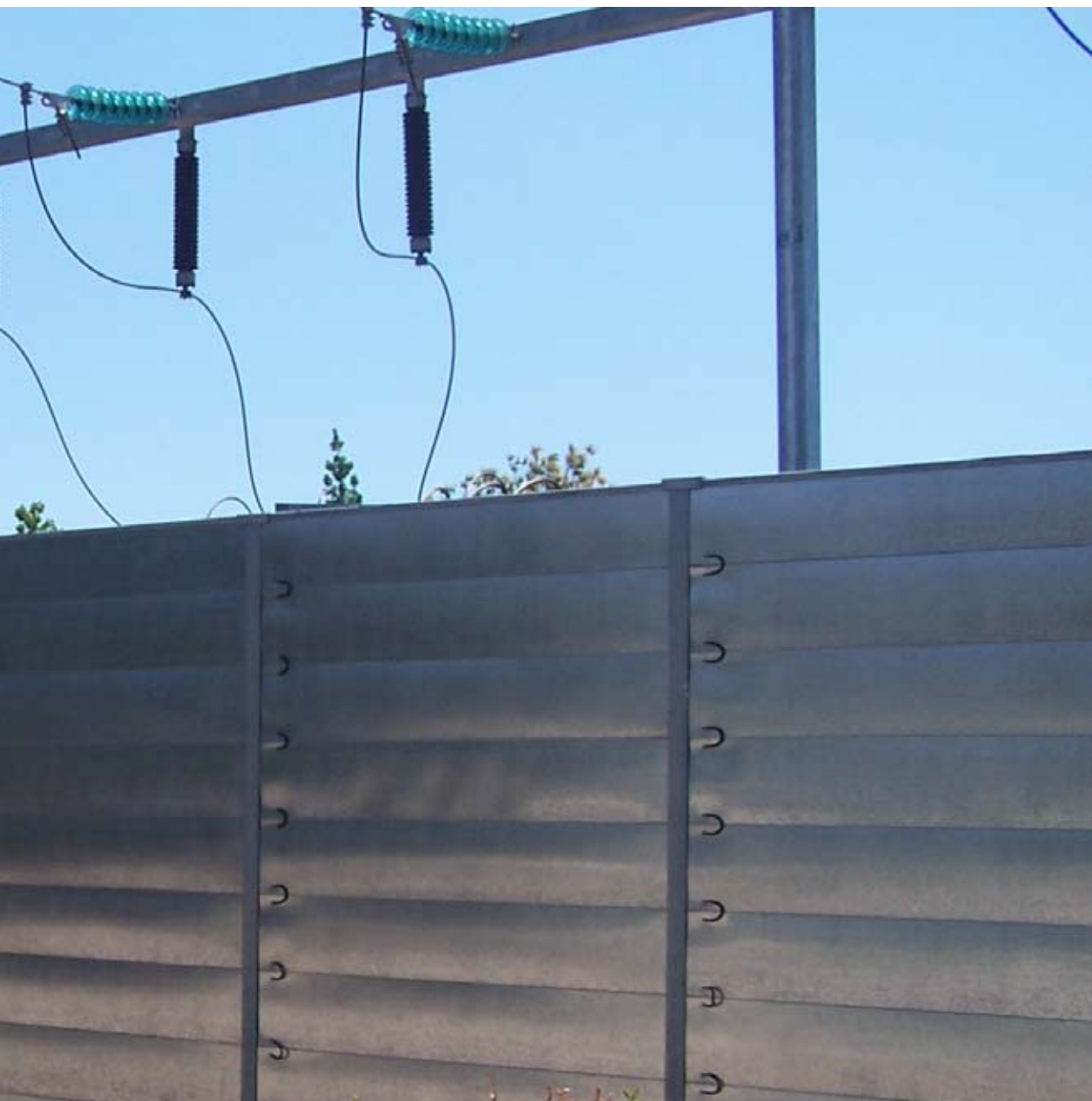
Pantallas Acústicas, subestación Los Dominicos.
