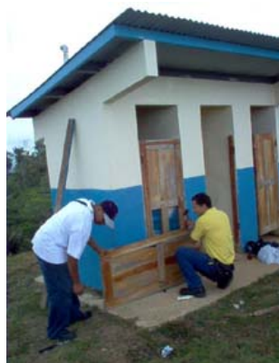
Reparación de la escuela Llano de Cartí ubicado en el límite entre Chepo y la Comarca Kuna Yala
