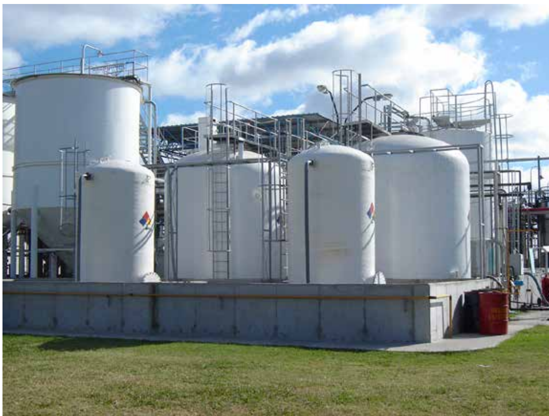
Tratamiento Físico Químico de residuos líquidos peligrosos.
