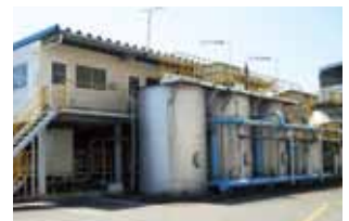
三島工場の排水処理設備
