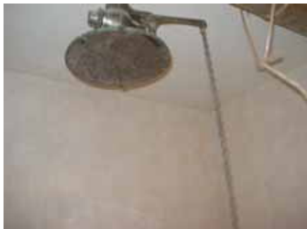
REGADERA DE SEGURIDAD
