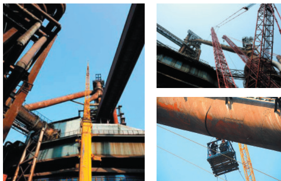
消除三高炉煤气下降管局部开裂隐患
