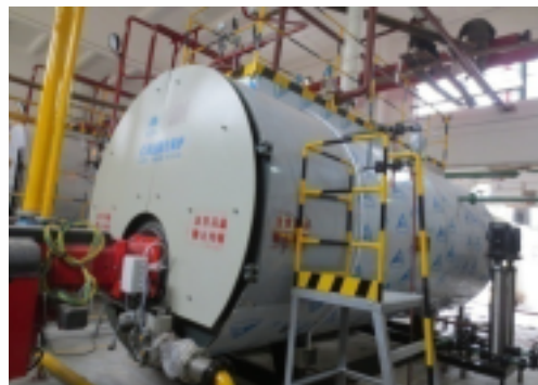
新建燃气锅炉
