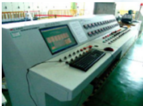
DC变流器试验系统
