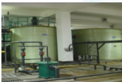
废水处理设施
