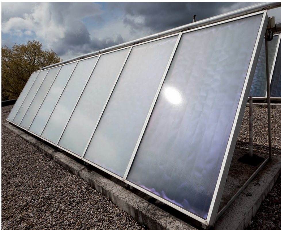
Placas solares de la sede de Landaben.
