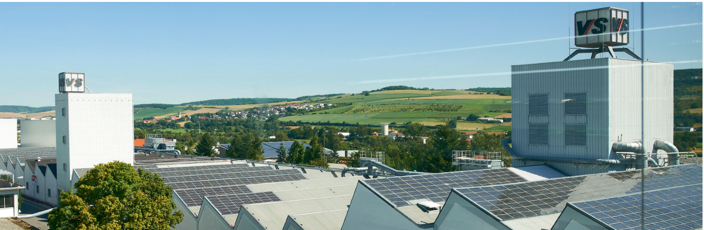
Installierte Fotovoltaikanlage auf den Dächern bei VS (Werk I)
