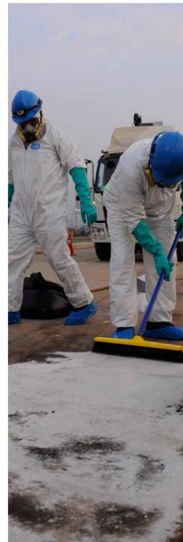
En el mes de diciembre se realizó simulacro sobre derrame de aceite en la vía pública, por parte de la Gerencia Técnica.
