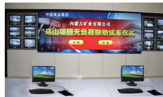
内蒙古乌山矿业公司中心控制室
