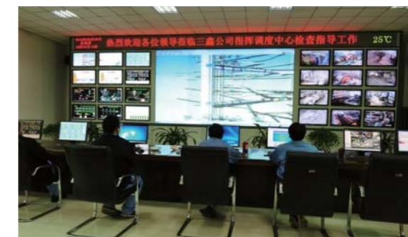
湖北三鑫公司中心控制室
