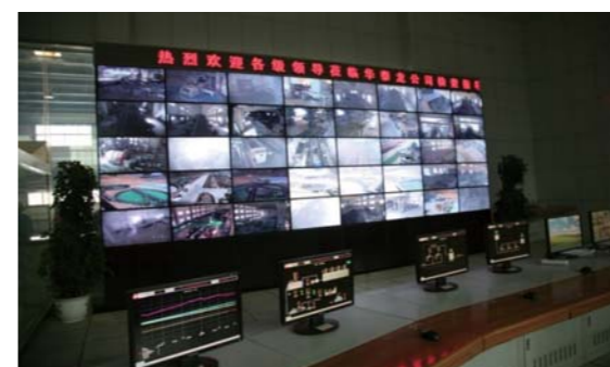
西藏华泰龙公司中心控制室
