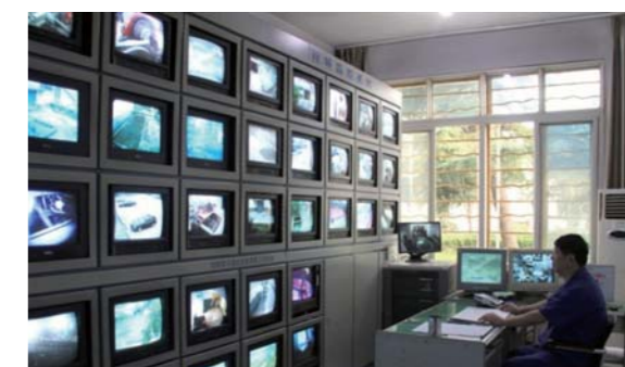
河南秦岭公司中心控制室
