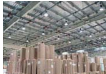
LED照明化した場内
