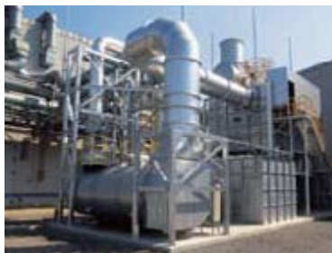
土居加工工場の排熱ボイラ
