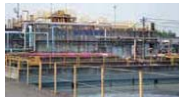
熊谷工場の排水処理設備
