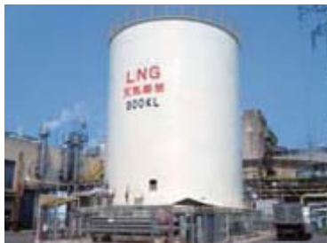
三島工場のLNGサテライト設備
