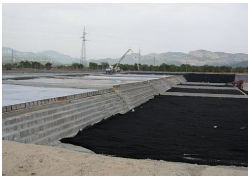
Depósito de seguridad de cenizas.
