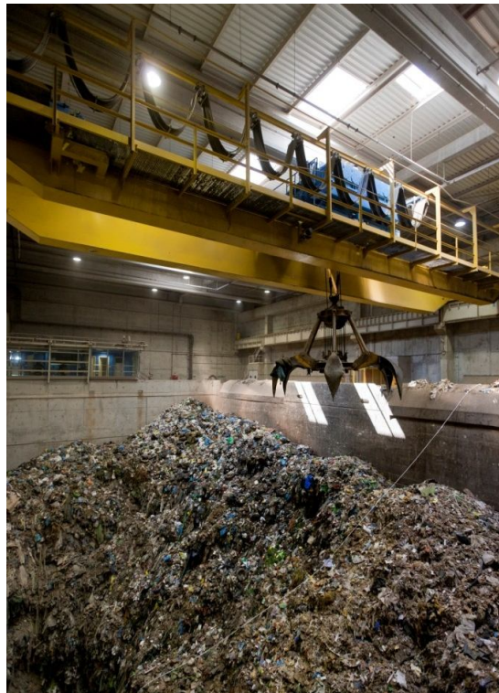
Foso de residuos en la planta de incineración con recuperación energética.
