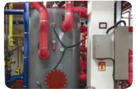
방학사옥 지열 냉난방시설
