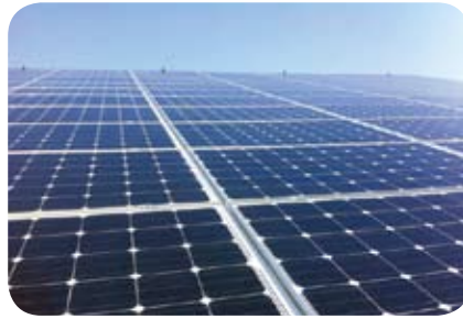
태화산 태양광 발전시설
