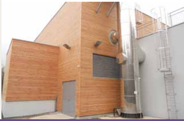
Chaudière bois à la Chantrerie
