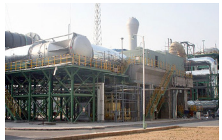
利用高炉煤气压差发电 (TRT压差发电)
