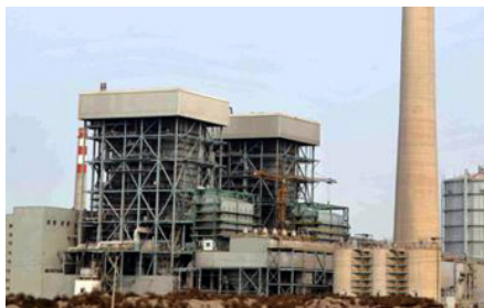
利用高炉煤气作为主要燃料的自备电站
