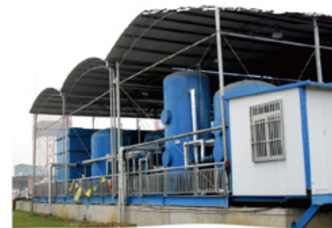
安徽矿业净水工程
