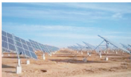
江苏大丰光伏发电项目建设规模为20MWp，是集团公司首批光伏项目之一，2010年建成投产。
