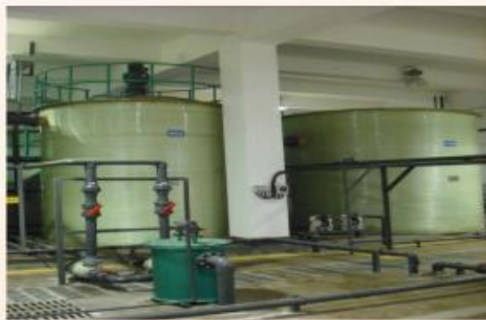
含氟废水处理设施
