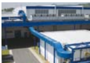
空調エアの排気ダクト
