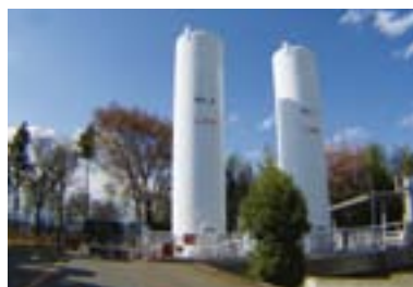
LNGサテライト設備
