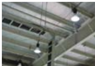
LED照明化した場内
