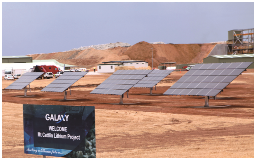
凯特琳矿山太阳能光电板电力供应系统
