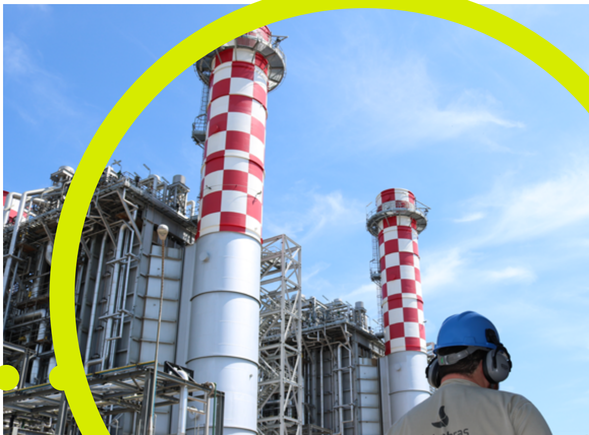
Usina Termelétrica Mauá. Acervo Amazonas GT
