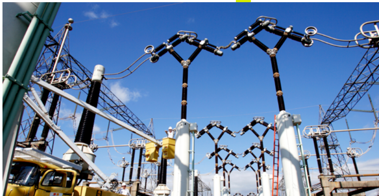
Substação da Usina de Itaipu. Foto: Caio Coronel
