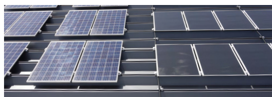
他社シリコン系商品と並べて設置することで発電量を比較検証
