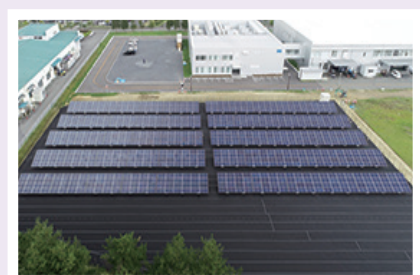
太陽光発電設備
