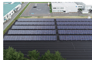
太陽光発電設備 (一関ヒロセ電機)
