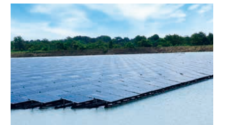
FETL社カビンプリ工場内のため池に設置された水上太陽パネル
