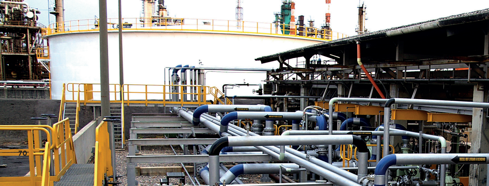
Casa de Bombeo Refinería de Barrancabermeja, departamento de Santander
