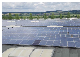
Das neue „Solarkraftwerk“ in Dingolfing
