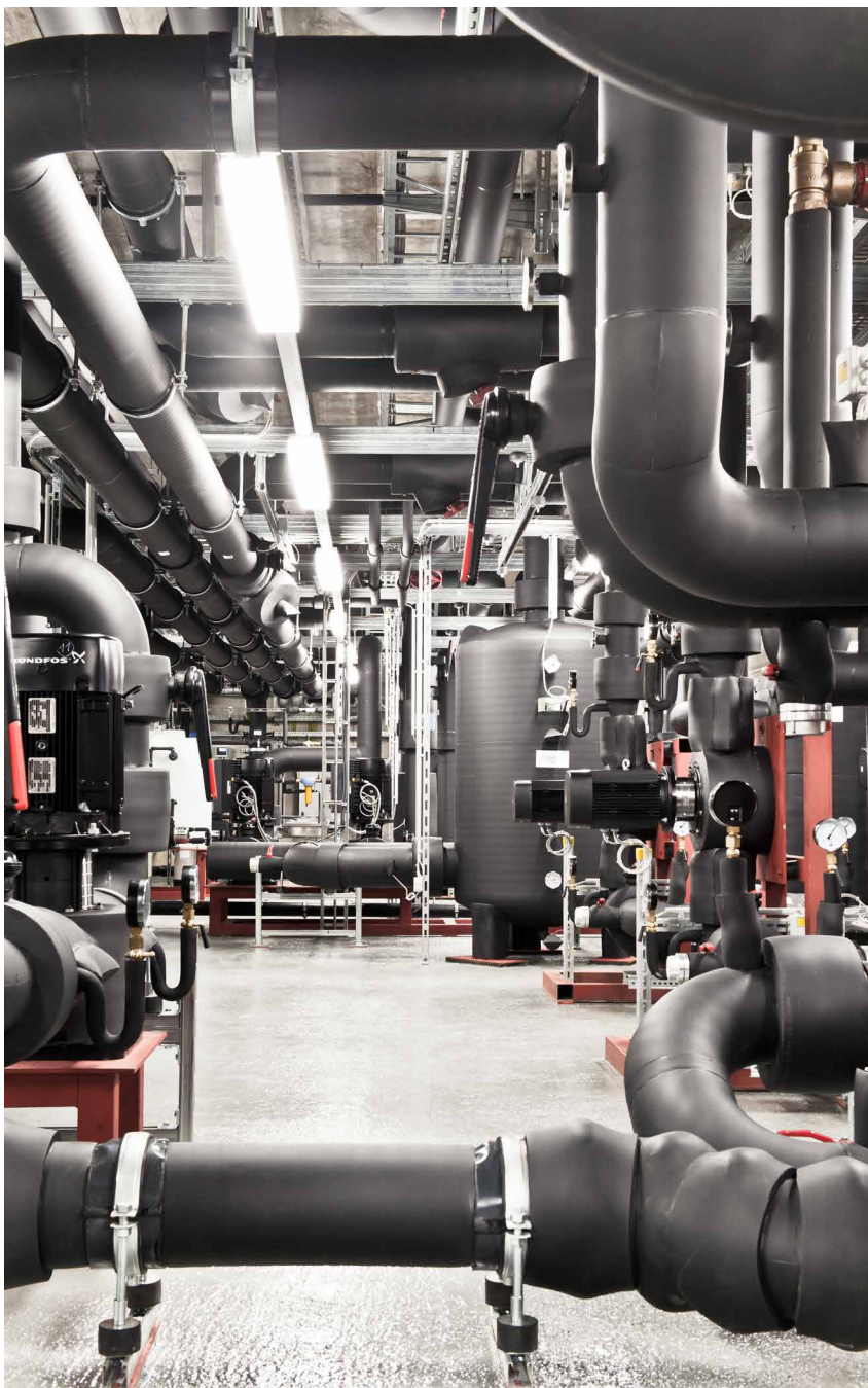
Moderne Technik ermöglicht die Wärmerückgewinnung im eigenen Haus
